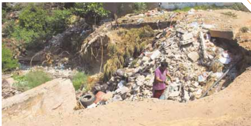
En la calle principal de Los Robles, la cañada y las aguas negras han hundido toda la calle. Foto: Laura Peña
