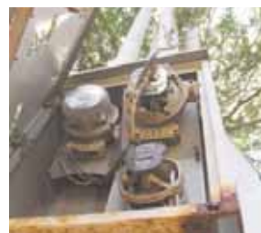
En pésimo estado están los reguladores eléctricos de la comunidad. Foto: Juan Guerrero
