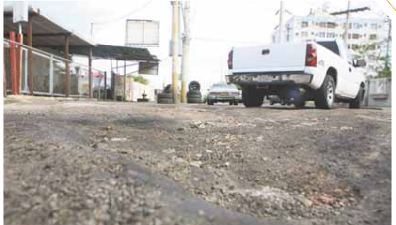
Vialidad de la urbanización Los Olivos está en pésimo estado y conductores exigen reasfaltado. Foto: Miguel Romero
